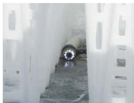
槽内点検カメラ
