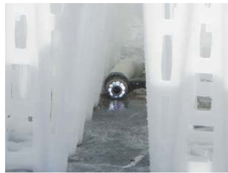
槽内点検カメラ
